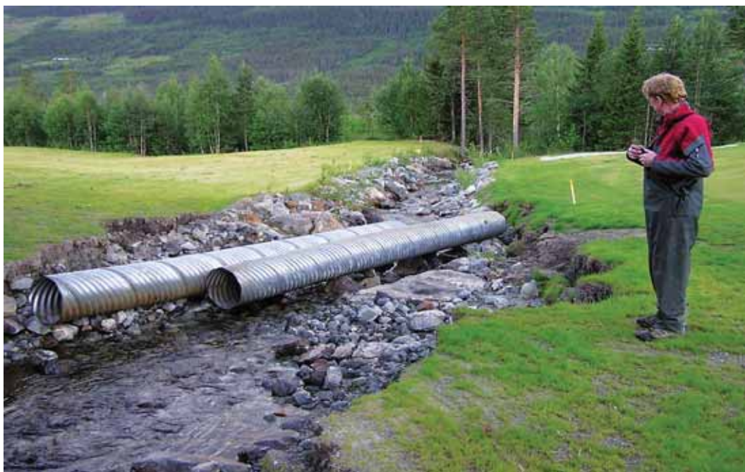
På en anden norsk bane, Hallingdal Golf Club, har kraftig afstrømning skabt en voldsom erosion. Her blev der bagefter lagt afvandingsrør ned for at undgå lignende problemer næste gang regnen styrter ned.
